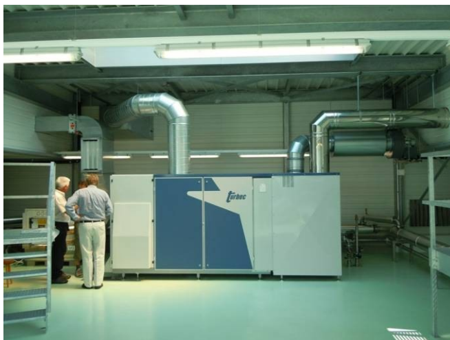
Figura 2: microturbina da 105 kW el dell'IDA di Nendaz (Vallese)
